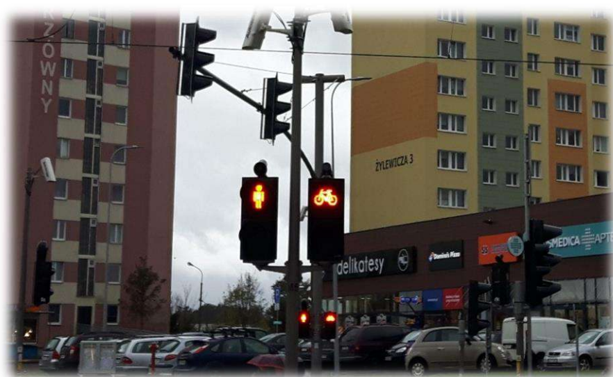
Foto nr 75. Zamontowane na maszcie dwie kamery, z których obraz jest analizowany w systemie sterującym sygnalizacją. Jedna kamera dostosowana do ruchu rowerowego, a druga do ruchu pieszego.
