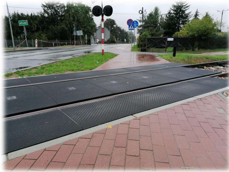
Foto nr 65. Przejazd dla rowerzystów na przejeździe kolejowym bez zapór.
