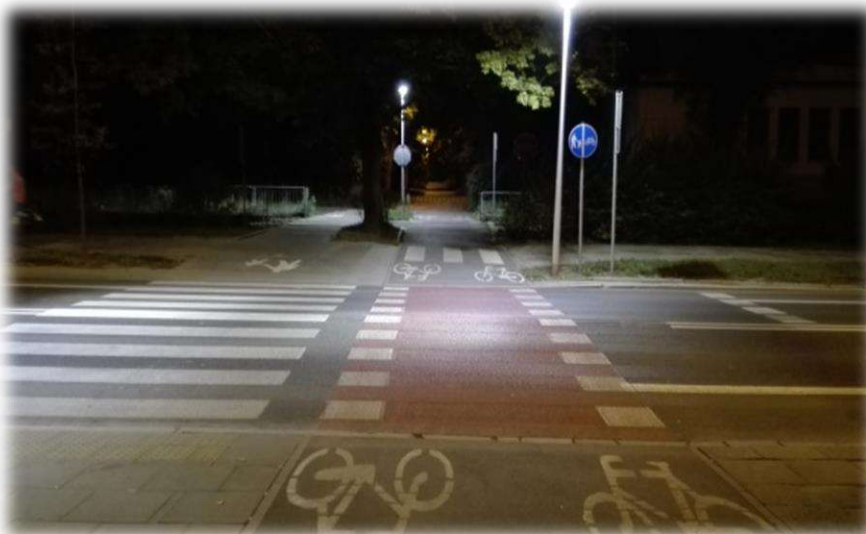
Foto nr 71. Oświetlenie przejazdu dla rowerzystów i przejścia dla pieszych.
