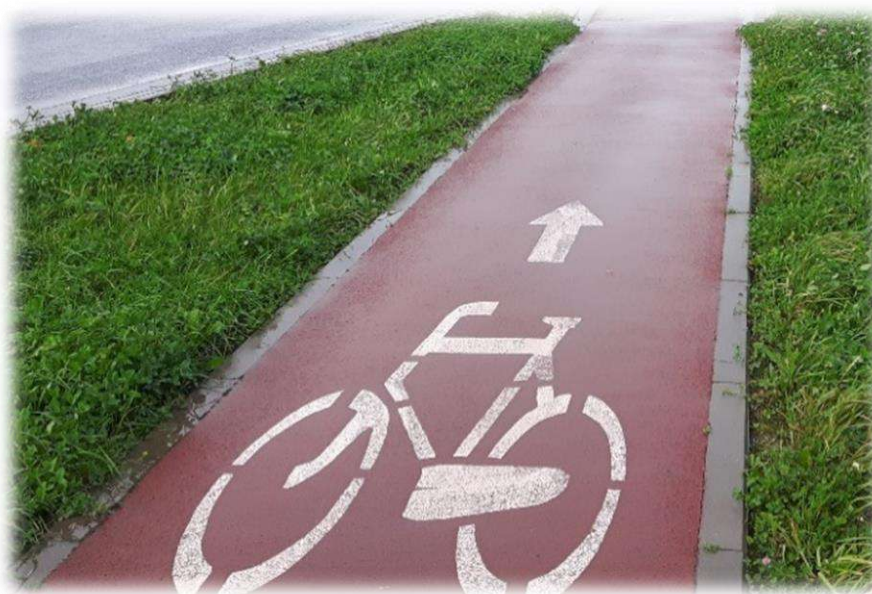
Foto nr 5. Wydzielona droga dla rowerów – jednokierunkowa (szerokość 1,5 m, nawierzchnia asfaltowa (czerwona), oznakowanie poziome P-23 oraz P-8a strzałka kierunkowa).
