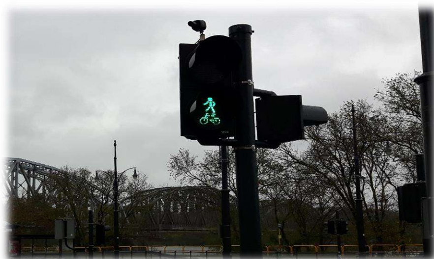
Foto nr 80. Sygnalizator dwukolorowy dla pieszych i rowerzystów S-5/6. Wświetla sygnały jednocześnie dla pieszych i rowerzystów.
