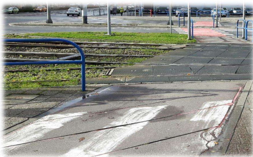
Foto nr 77. Detektor automatyczny dla rowerzystów z pętlą indukcyjną wbudowana w drogę dla rowerów.
