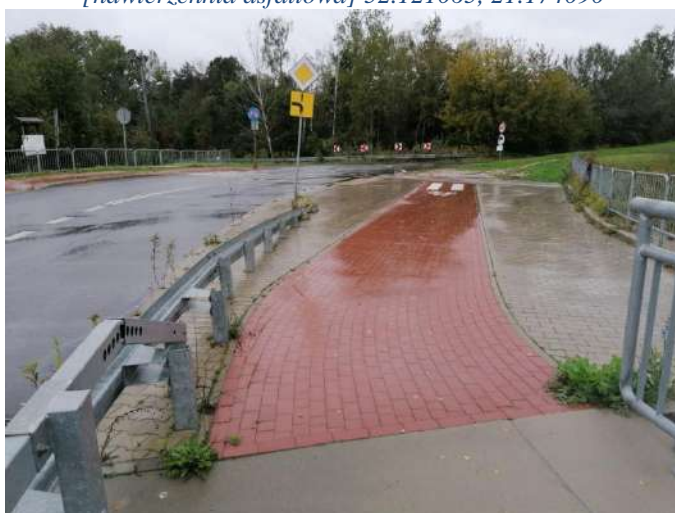
Foto nr 240 [w kierunku północno-zachodnim] droga dla rowerów za mostem ujścia Jeziorki do Wisły [nawierzchnia z kostki betonowej niefazowanej] 52.120986, 21.174326
