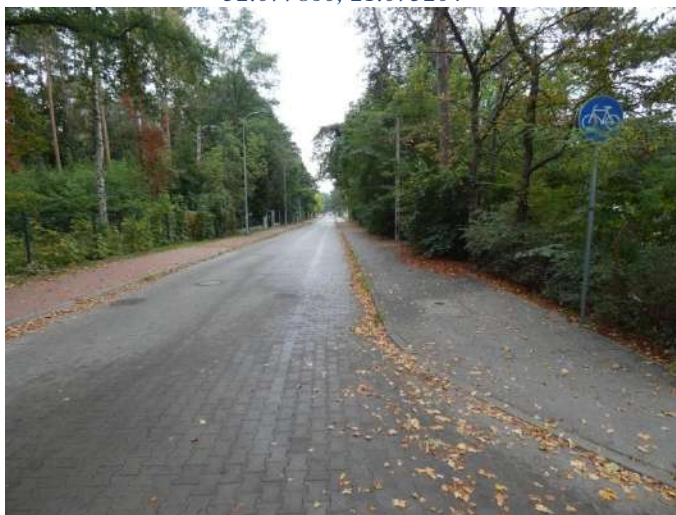
Foto nr 63 [w kierunku południowym] ul. Przesmyckiego skrzyżowanie z ul. Broniewskiego [droga dla rowerów, nawierzchnia asfaltowa – szer. 2,0 m] 52.080094, 21.075182
