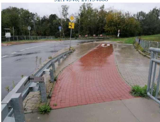
Foto nr 240 [w kierunku północno-zachodnim] droga dla rowerów za mostem na Jeziorce w m. Obórki [nawierzchnia z kostki betonowej niefazowanej] 52.120986, 21.174326
