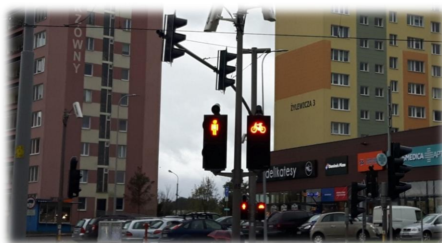
Foto 74. Zamontowane na maszcie dwie kamery, z których obraz jest analizowany w systemie sterującym sygnalizacją. Jedna kamera dostosowana do ruchu rowerowego, a druga do ruchu pieszego.
