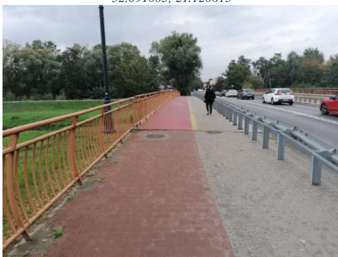
Foto nr 59 [w kierunku północno-zachodnim] ul. Warszawska most nad Jeziorką [droga dla pieszych i droga dla rowerów, nawierzchnia z kostki betonowej fazowanej szer. 2,0 m i niefazowana szer. 2,5 m na moście nawierzchnia betonowo-żywiczna] 52.090912, 21.120765
