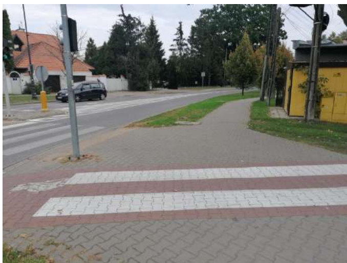
Foto nr 13 [w kierunku wschodnim] ul. Mirkowska [chodnik, nawierzchnia z kostki betonowej fazowanej – szer. 2,0 m] 52.102732, 21.114596
