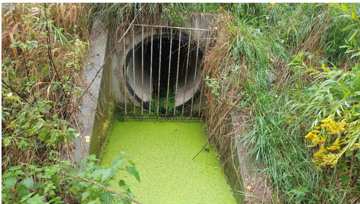
Fot. 2 Wylot kolektora deszczowego z ul. Kościuszki, Dolna, Nowa, Górnośląska, Traugutta, Bema.
